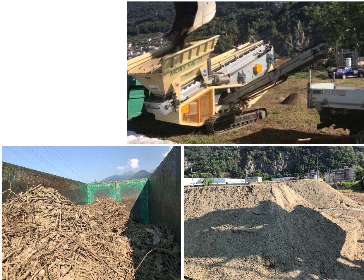
Fig. 13 Le tamisage effectué in situ selon différentes dimensions des mailles du crible (jusqu'à 0.5/1.0 cm) permet de réduire jusqu'à -80% le volume de matériel d'excavation à transporter et à mettre en décharge / incinérer. En haut : tamis mobile avec trémie ; en bas à gauche : matériel contaminé à éliminer par incinération ; en bas à droite : matériel criblé à 0.5 cm considéré assaini (sans rhizomes viables) et pouvant être laissé sur site. Photos : chantier CFF à Riazzino (TI).
