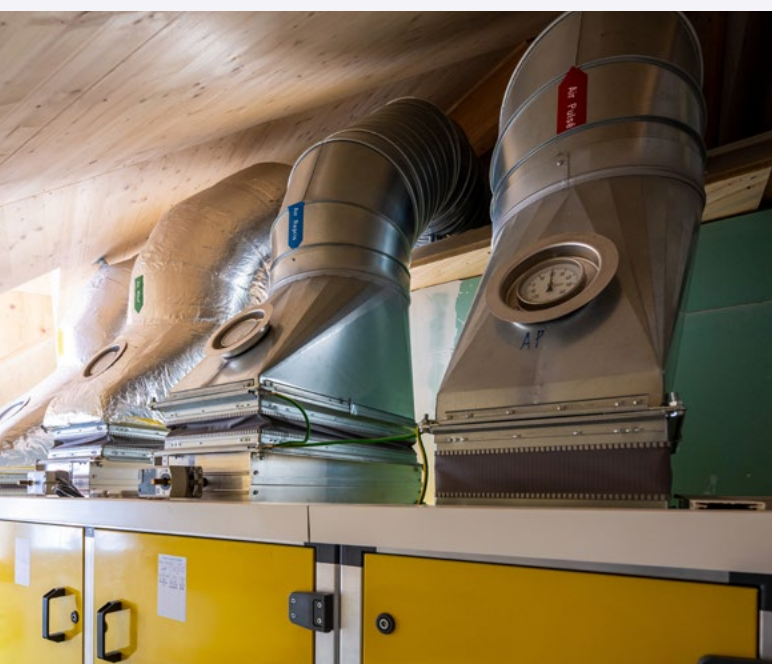
La ventilazione controllata con recupero del calore residuo aumenta l'efficienza energetica della casa.
