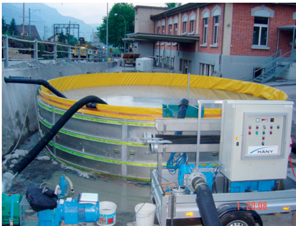
Esempio di un contenitore di ritenzione mobile
