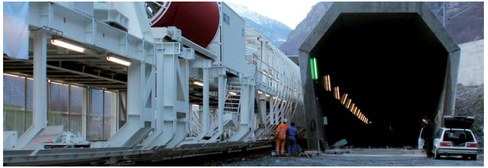
La realizzazione completa di AlpTransit è di grande importanza per meglio integrarsi nel contesto urbano svizzero/internazionale.
