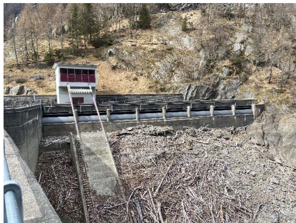
Figura 13: Sfiatore della diga del Sambuco (fonte: Ecocontrol 2022)
