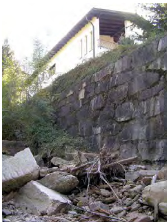
Figura 10: avallamento pronunciato artificiale
