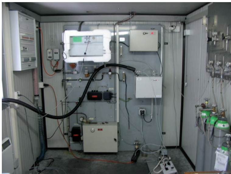
Figura 6.4 – Stazione d’analisi in continuo delle emissioni di SO 2 presso la Timcal SA, Bodio
