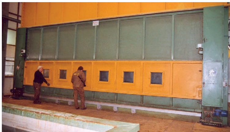
Fig. 4.24 – Captazione totale dei vapori di zincatura mediante una cabina chiusa (Metallizzazione SA, Lamone)
