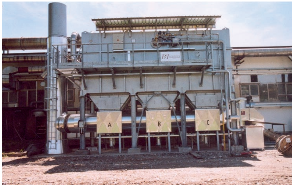
Fig. 4.21 – Combustore termico rigenerativo per ridurre le emissioni di composti organici volatili presso la VBL SA (ex-Stabio Textil SA) a Stabio
