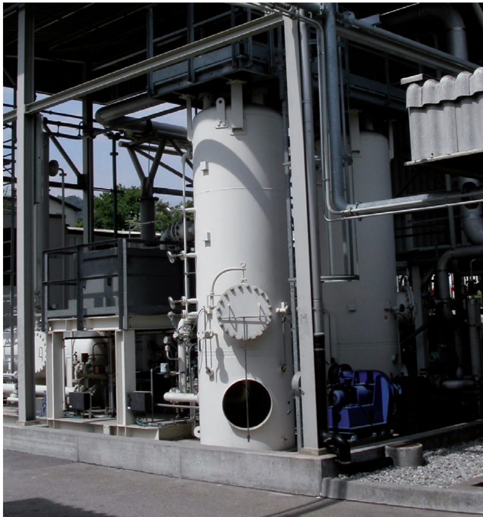
Fig. 4.17 – Impianto di adsorbimento su carbone attivo per il recupero dei vapori di benzina presso il deposito di carburante Benoil SA, a Rancate
