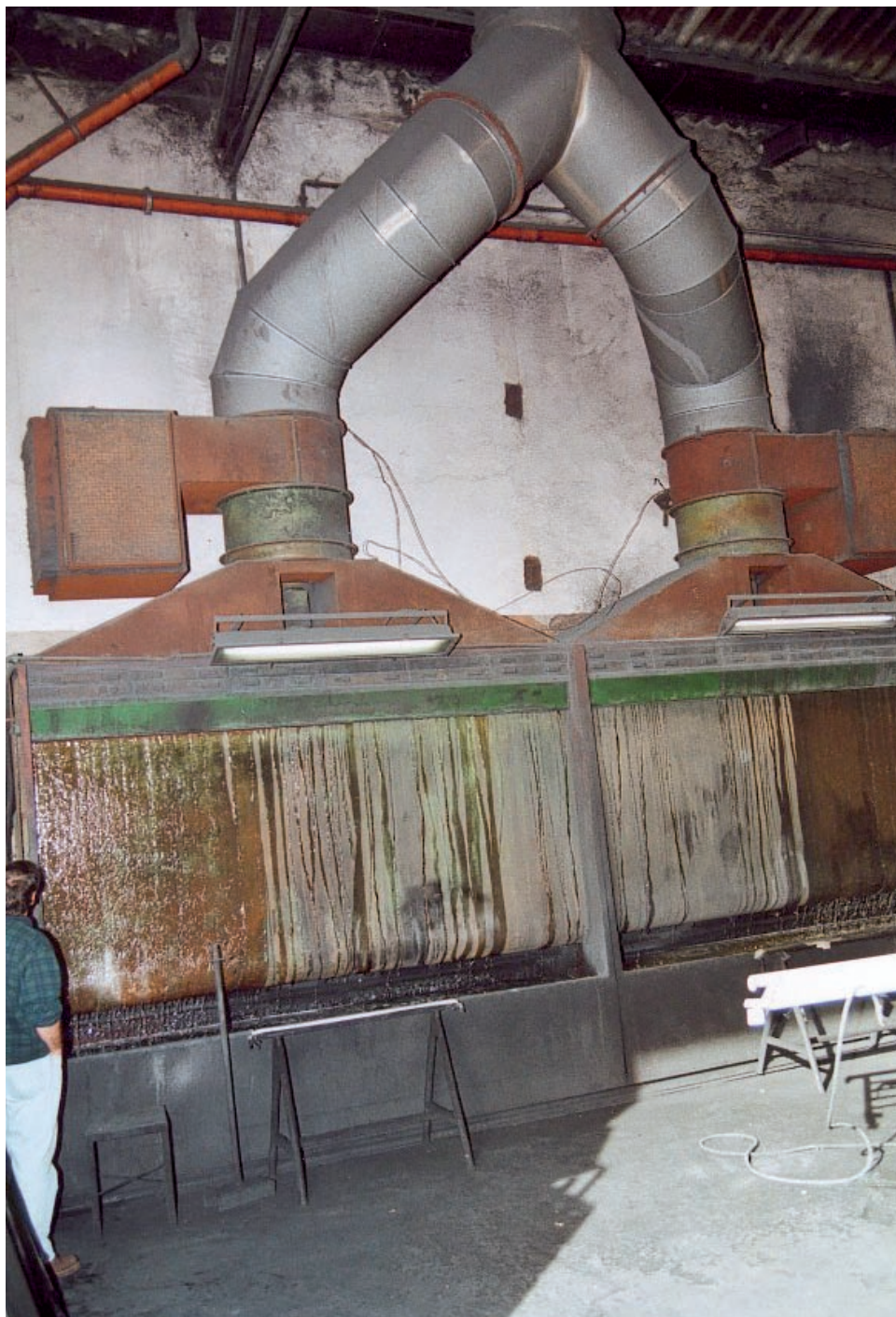
Fig. 4.8 – Impianto di verniciatura con filtro a velo d'acqua presso la Metallizzazione SA, a Lamone
