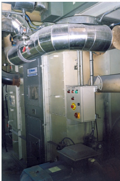
Figura 6.7 – Impianto d'abbattimento dei COV della ditta Precicast SA, Novazzano
