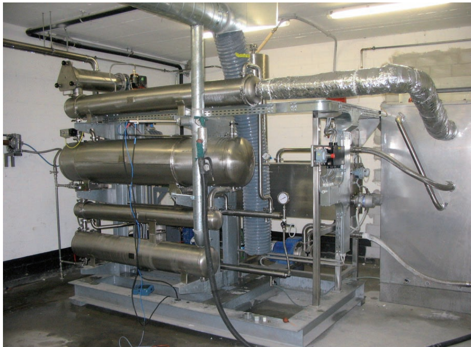
Fig. 4.20 – Impianto di recupero di solventi organici per condensazione, Polyeflon, Biasca
