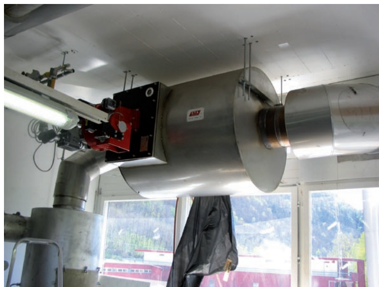
Figura 6.8 – Impianto di postcombustione dei fumi dell'impianto di tostatura per abbattere le emissioni di COV, Torrefazione Caffè Ferrini, stabilimento di Tavernes
