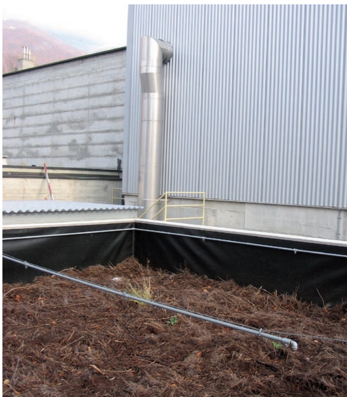
Fig. 4.22 – Biofiltro, Consorzio depurazione acque, Impianto Foce Ticino
