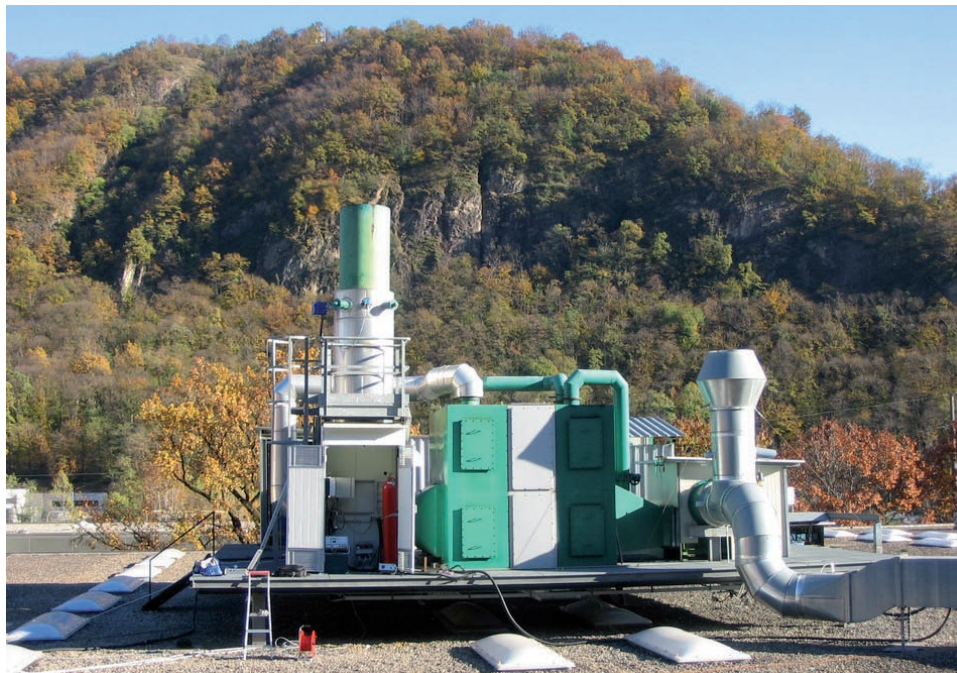
Figura 6.6 – Impianto d’abbattimento dei COV della Osmopharm SA, Bedano
