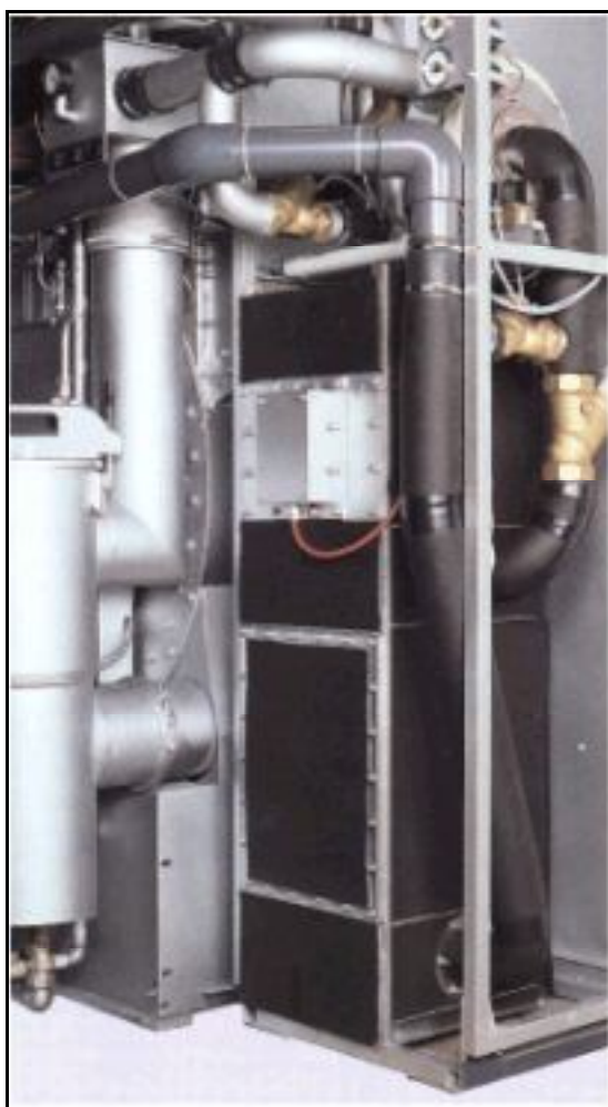
Figura 7: Trattamento finale di deodorazione (decontaminazione) dell'aria con carboni attivi, che vengono in seguito rigenerati con aria calda per permettere il recupero del solvente.
