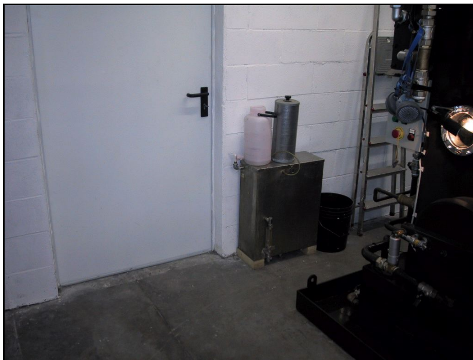
Figura 8: Impianto di trattamento finale acque di contatto.
