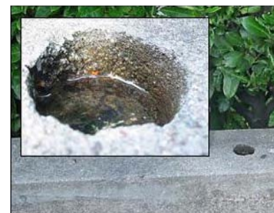
Figura 6 Fessure in un muretto
