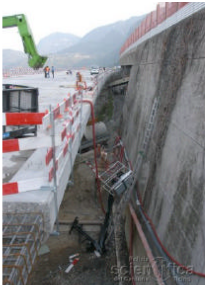
Sul cantiere autostradale a Capolago, un operaio precipita da oltre 6m con la navicella su cui era sospeso.
