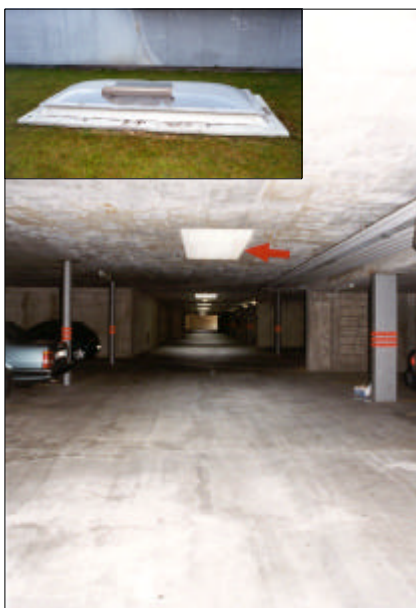
28 giugno: due ragazzi di 13 e 11 anni giocano nel giardino di un palazzo in Via Saleggi a Locarno. Improvvisamente, sotto il loro peso, il lucernario su cui si trovavano cede, e i ragazzi precipitano per circa 3 metri nella sottostante autorimessa.
