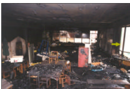
6 febbraio: incendio presso l'asilo di Mezzovico. I pompieri di Mezzovico intervenivano con 21 uomini e 3 automezzi e riuscivano a domare le fiamme che si erano estese al piano superiore, dove si trova la mensa e la cucina, provocando danni ingenti. Nessuna persona è rimasta ferita.
